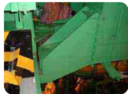
北西側脱線防止ラグ
