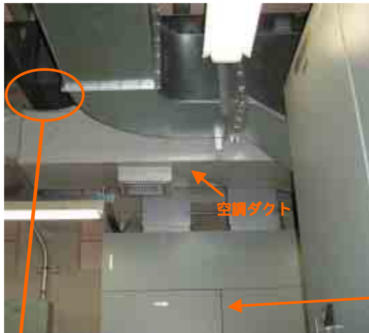
原子炉建屋中3階オペフロ水漏出箇所（非管理区域）
