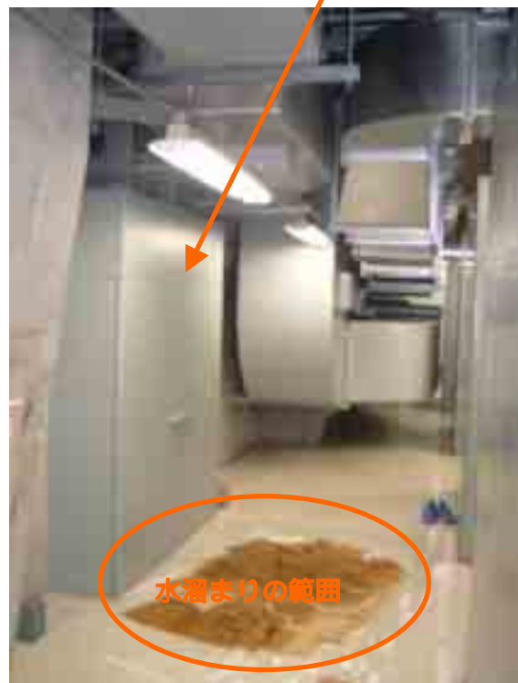
原子炉建屋中3階漏えい状況（非管理区域）
