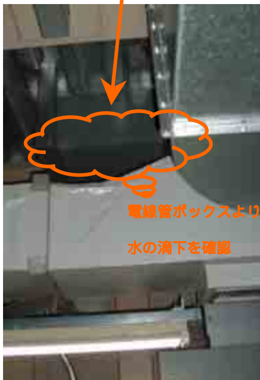
原子炉建屋中3階電線管ボックス（非管理区域）
