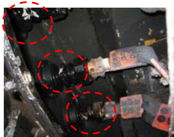
写真2 二次ブッシング碍管破損(下段)
