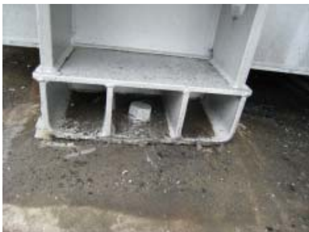
写真8 基礎ボルト頭部曲がりあり
