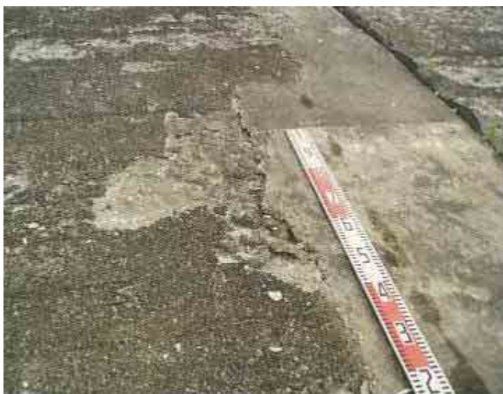
写真－１２ 表面遮水壁剥落状況 (気中部：A10ブロック)
