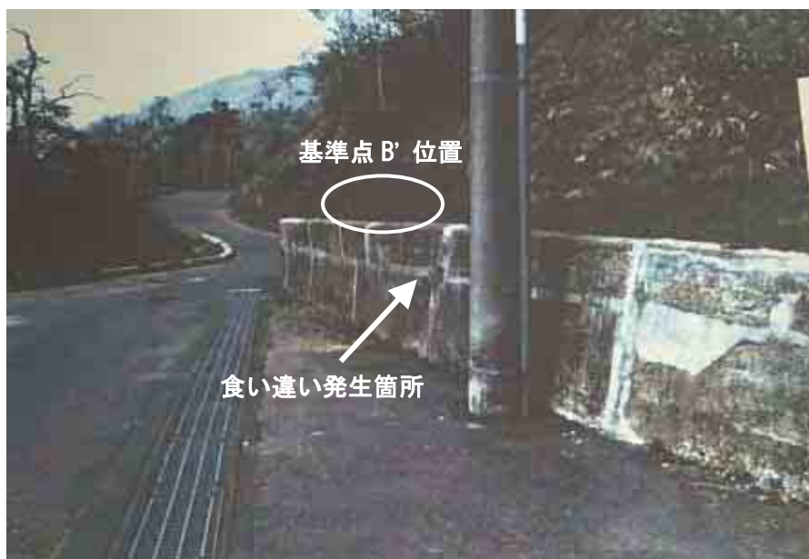
写真－7 中段右岸道路擁壁（基準点 B' 近傍） 食い違い状況：遠景（平成 2 年）
