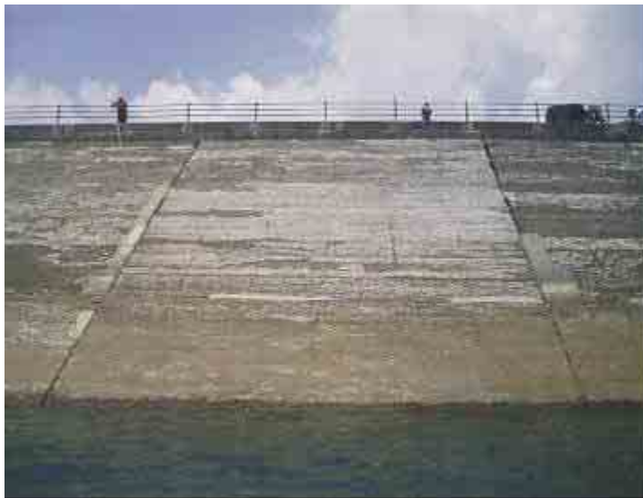
写真－１１ 表面遮水壁劣化状況 (気中部：A11, B11ブロック)
