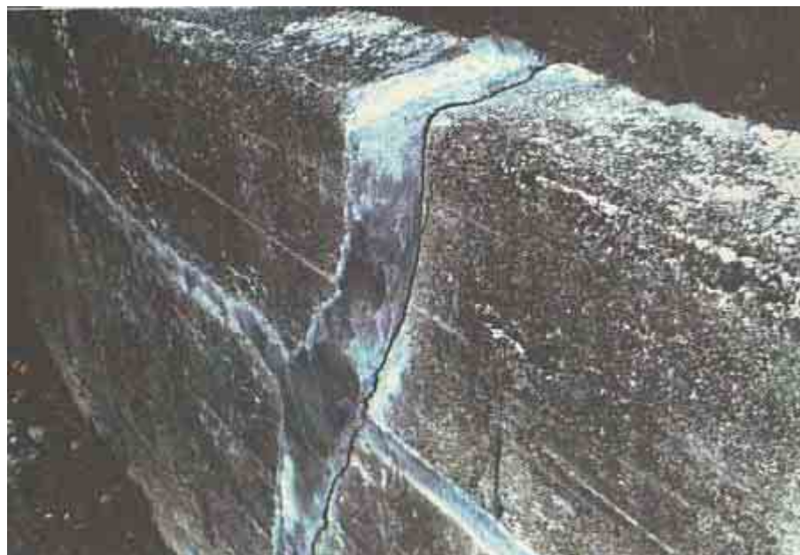
写真－8 中段右岸道路擁壁（基準点 B' 近傍） 食い違い状況：近景（平成 2 年）
