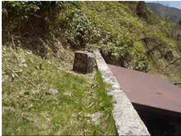
写真-9 上段右岸基準点 A' の傾斜状況
