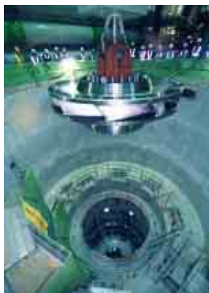
ポンプ水車ランナと現地施工状況
