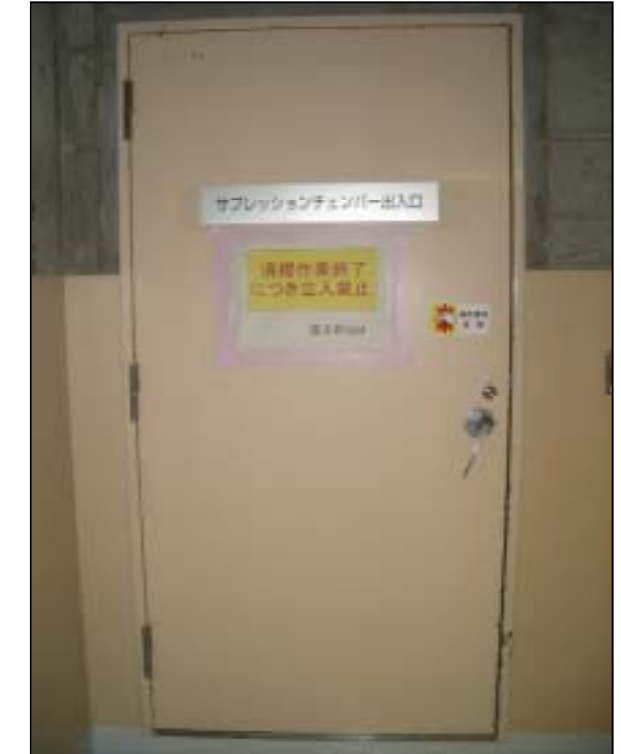
2F - 3 圧力抑制室入口 *
