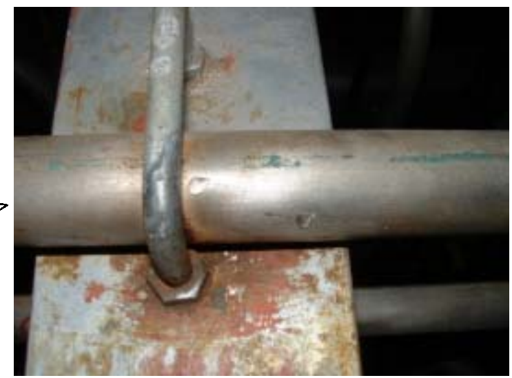
配管内からの水にじみ部写真
