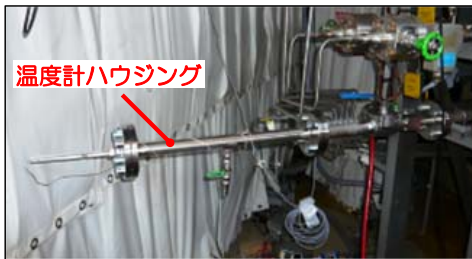
圧力容器温度計設置状況(H24/10/3)
