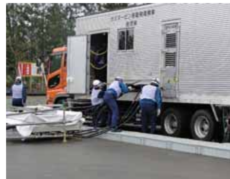
GTGによる電源供給訓練風景
