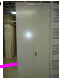
光ケーブル配線盤
