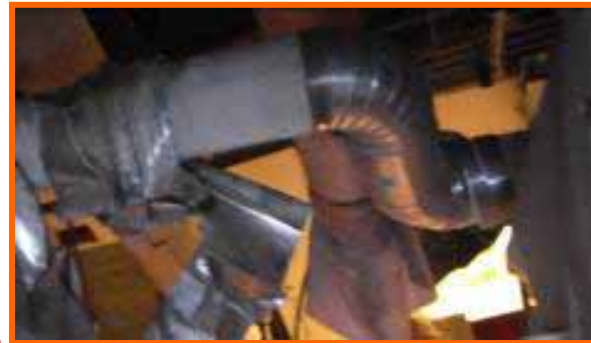
非常用復水器入口蒸気配管
