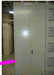
光ケーブル 配線盤
