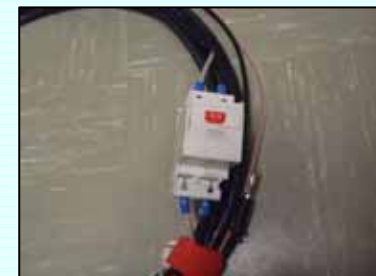
仮設操作スイッチと仮設ケーブル (1号機の例 仮設操作スイッチ1セット、仮設ケーブル30m)
