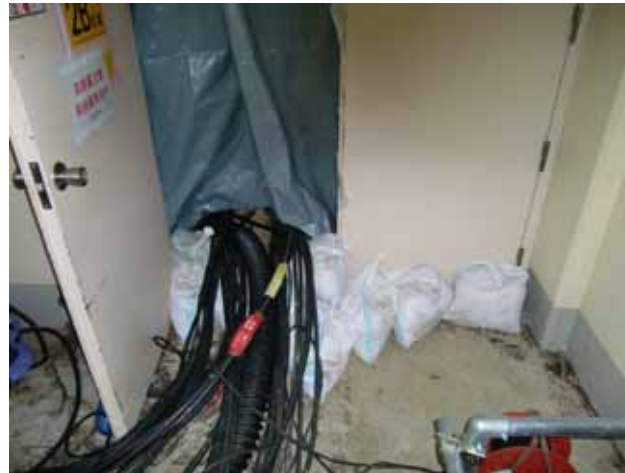
2号機タービン建屋パワーセンタ室入口
