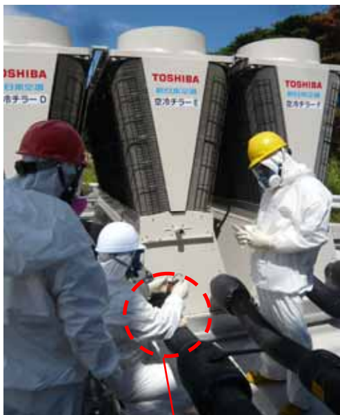
バッファタンク用冷凍機
