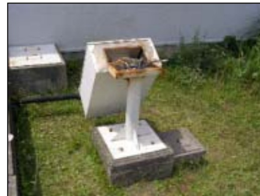
泡消火設備現場盤
