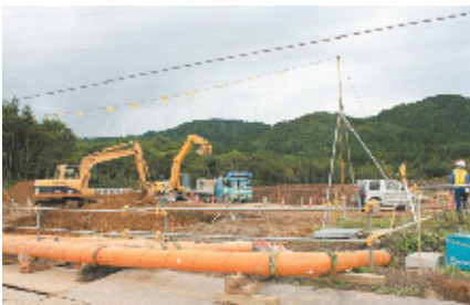
造成を開始したコンクリート製造施設設置場所の様子
