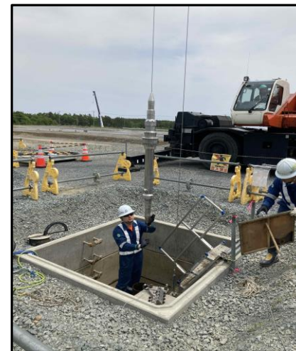
地震計の設置状況
