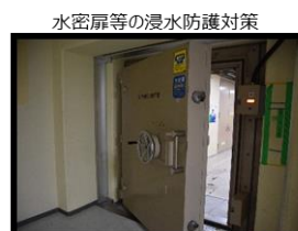
水密扉等の浸水防護対策
