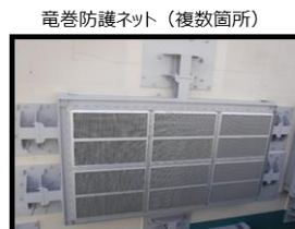
電巻防護ネット（複数箇所）
