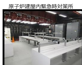
原子炉建屋内緊急時対策所
