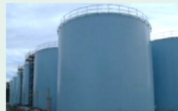
溶接型タンク
