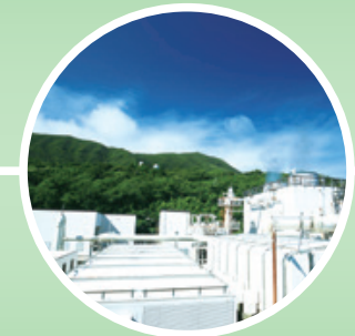
▲ 当社初の地熱発電所 八丈島発電所(0.33万kW 1999年～2019年)
