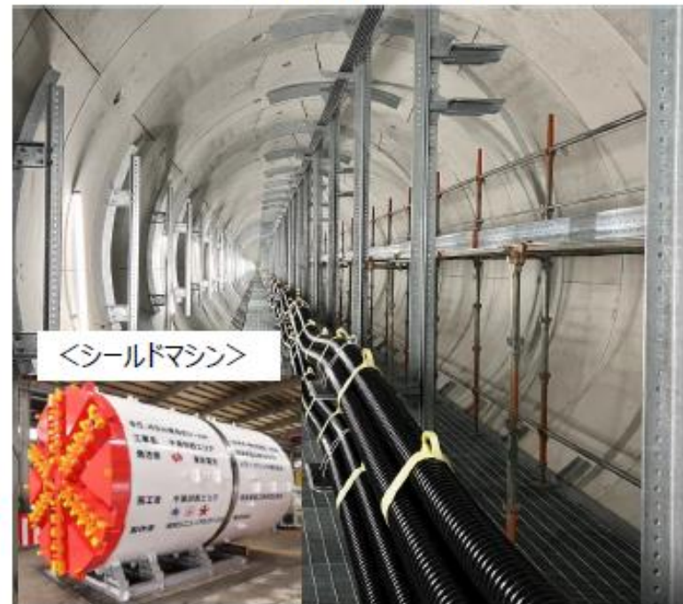
千葉印西エリア洞道内
