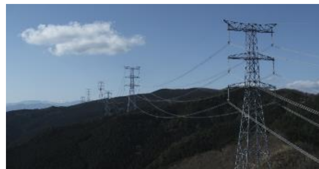
UHV交流送電線
