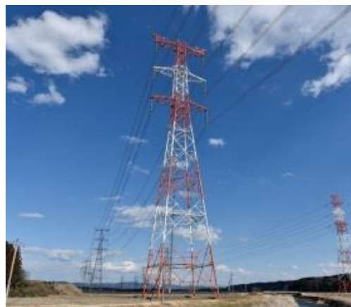
送電設備(架空)
