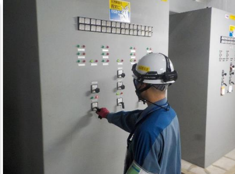
現場制御盤での操作
