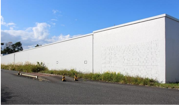
発電所構内にある固体廃棄物貯蔵庫
