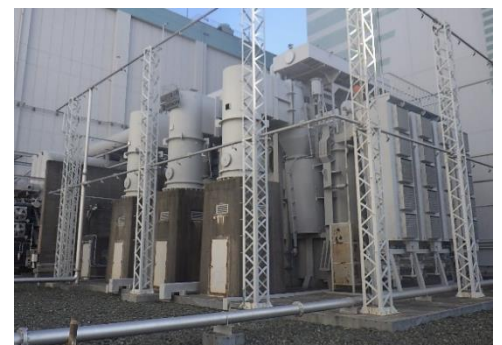
解体撤去となる電気設備（一例）
