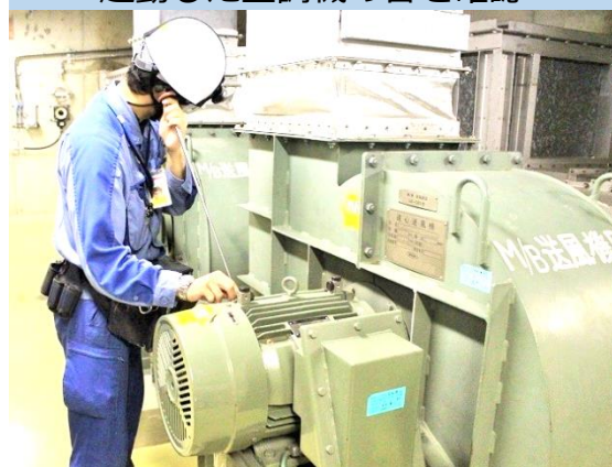
起動した空調機を確認
