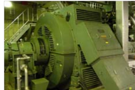
非常用ディーゼル発電機（発電機）
