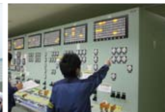
試験の様子（中央制御室）
