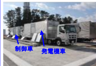
ガスタービン発電機車全景
