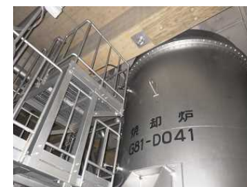
既設の焼却炉
