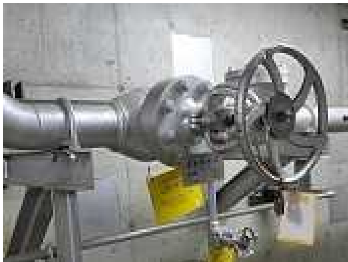
対象弁の隔離措置
